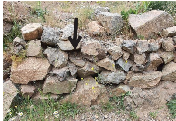
Photo 39. Nid de Moineau soulcie localisé dans le mur de soutènement d'une piste.
